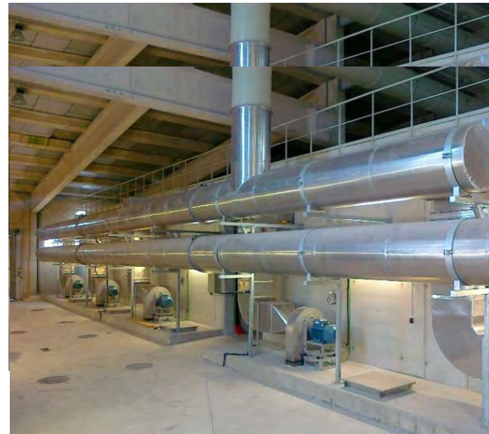
Galería de ventiladores
